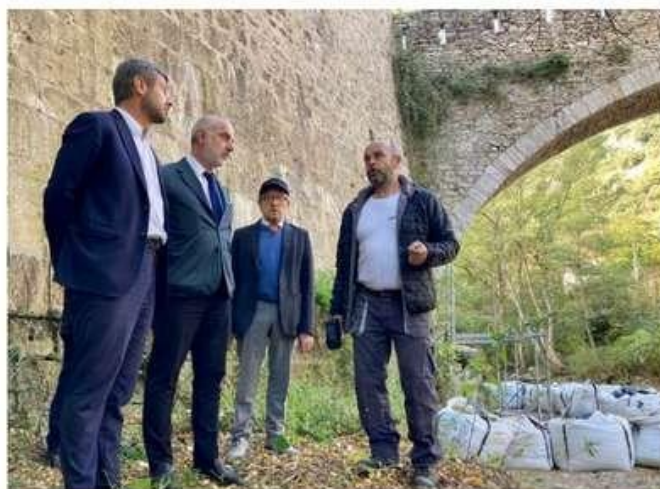
Le pont Saint-Pierre relie la cité fortifiée au fort Libéria. / Jimmy Phan
